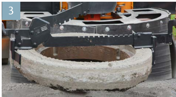
Schadhafte Abdeckung ausheben
